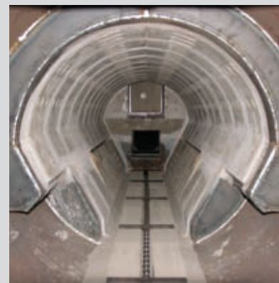
Verbrandingskamer met asketting.
