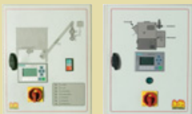
Vollautomatische Steuerung der Warmflufheizung und der EWI-THERM Siloaustragung.
